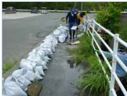
側溝から上げられた土のう袋
